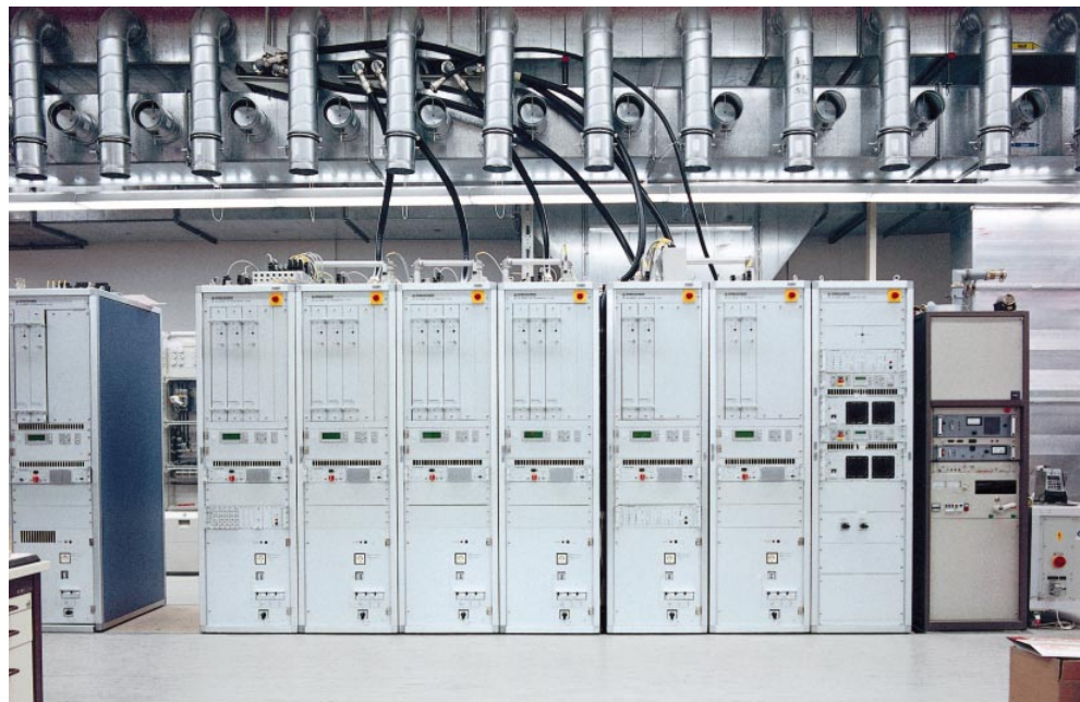
BILD 2 UKW-Sendeanlage im Prüffeld der FTK. Die für Aurich in Ostfriesland bestimmte Anlage besteht aus 3,75-kW-, 2,5-kW- und 600-W-Sendern.
